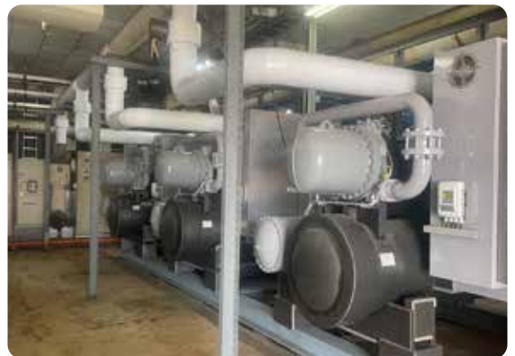
1 瑞儀光電針對空調系統進行汰舊換新，以一級能效冰水主機進行改善，以提升能源使用效率，並協助完成公司節能改善。
