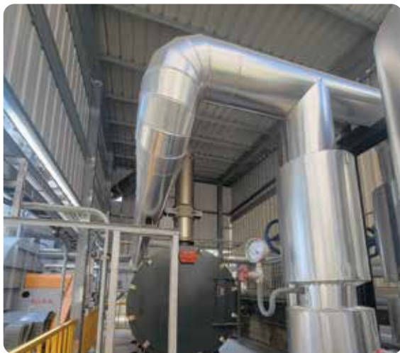
1 嘉成工業設置蓄熱式氧化爐及廢熱回收系統設備，並將熱能整合於原製程中，達到提升整體製程能源效益之目的。
